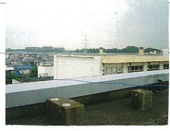
青いビニール電線 (屋上)
